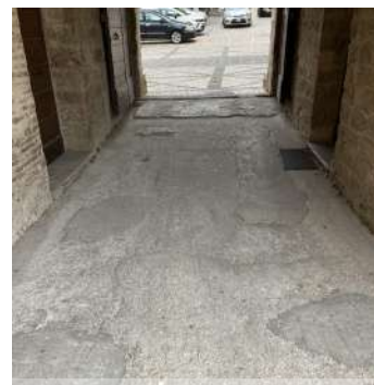
8.2B_Pavimentazi one disconnessa
